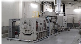
自家発電機設備
