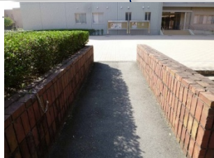
手すりがなく、見通しの悪いスロープ
